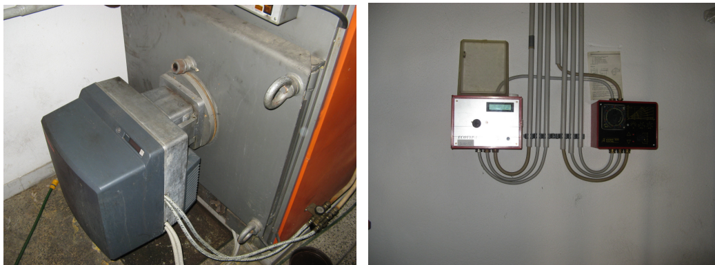
Slika 7: Kotel za ogrevanje in regulacija
